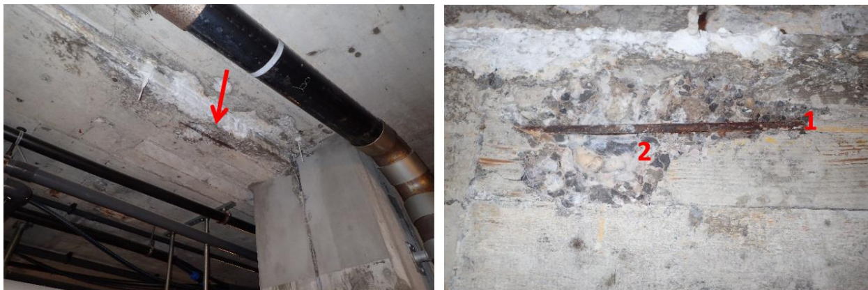
Bild 6 Beispiel stark korrodiertes Eisen im Untergeschoss mit Abplatzungen und Tropf- und Wasserspuren
