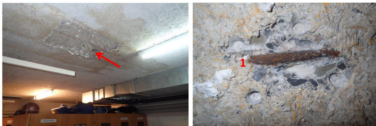
Bild 7 Starke Korrosion unterhalb der Dämmeinlage bei der Decke des Geräteraums (aus Bericht TFB AB [20])
