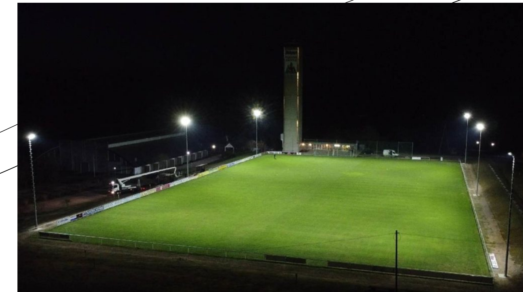
Referenzbild Sportplatzbeleuchtung mit LED Leuchten (Ersatz)
