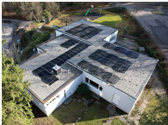
Photovoltaikanlage auf dem Flachdach der Langwattstrasse 46.
